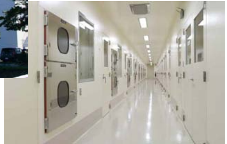
GMP製造設備
